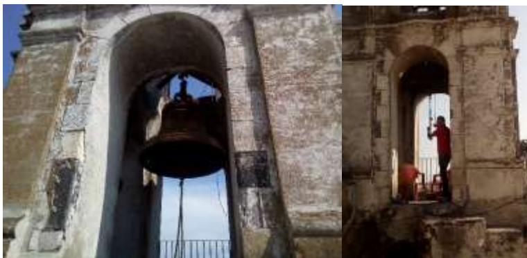
Fig. 5. Campanas del sur y norte.
