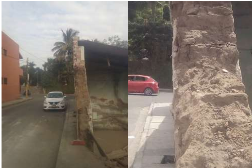
Fig. 5. Pared de adobe en peligro de colapsar
