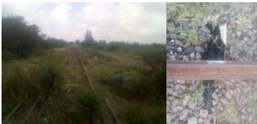
Fig. 5. Vía abandonada con maleza y durmiente quemado sin la zapata
